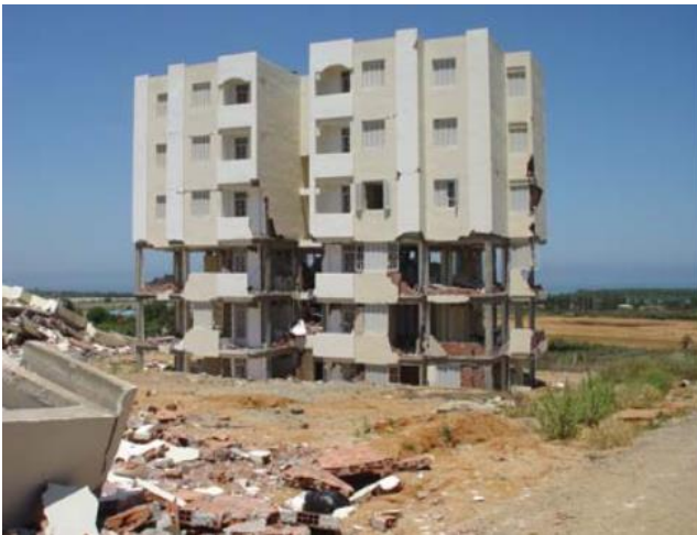
FigIII.2: On peut remarquer l'entaille au centre du bâtiment et sur toute la hauteur
