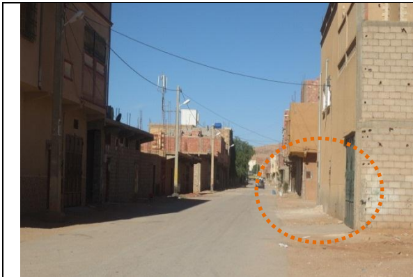
Fig. n°31 : la détérioration du trottoir
