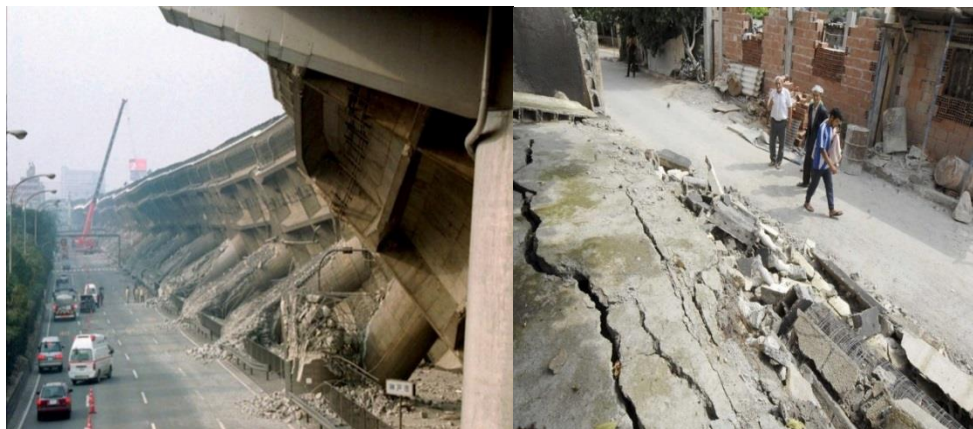
Figure 1.2: Effet de séisme.
