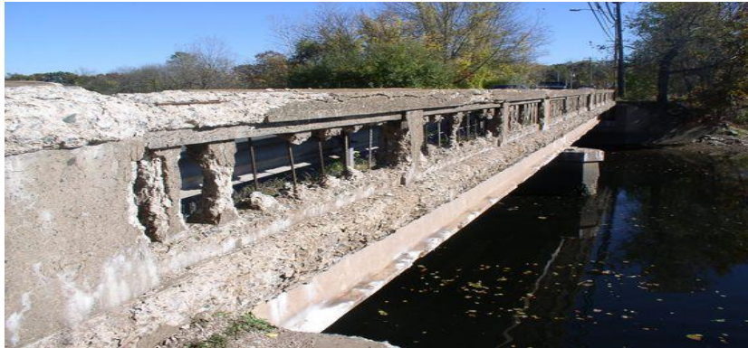
Figure 1.1: Dégradation d'un ouvrage soumis au gel-dégel.
