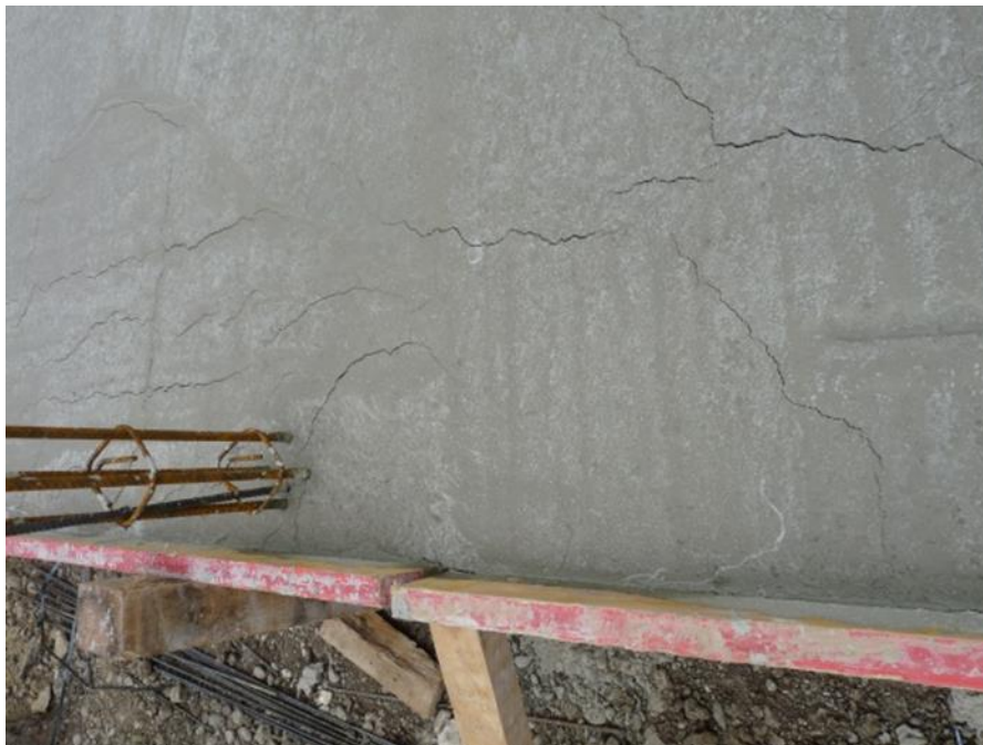
Figure 1.3: Retrait après le bétonnage.
