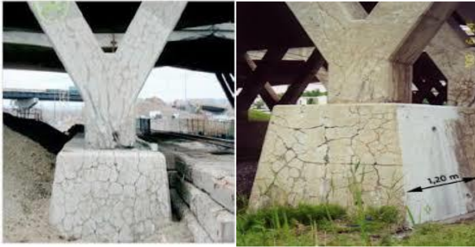
Figure 1.6: Fissurations grossières dues à l'alcali-réaction.
