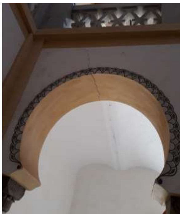
Figure 132: des fissurations au niveau de l'arc
