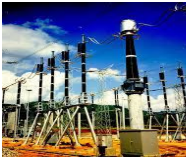
Fig.12 : Disjoncteur haute tension
