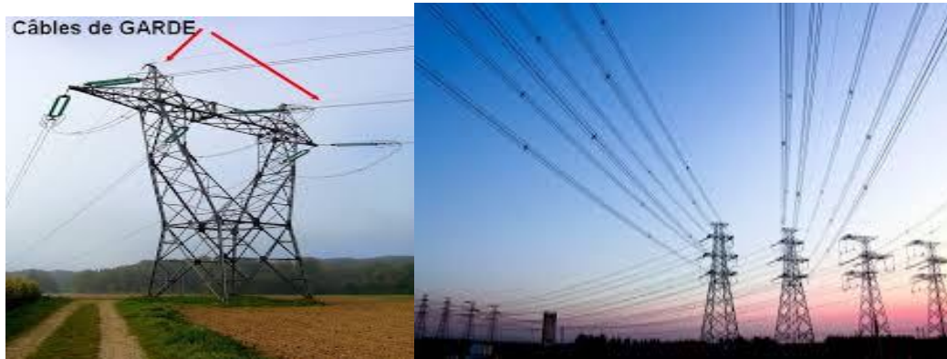
Fig.16 : Les câbles électriques
