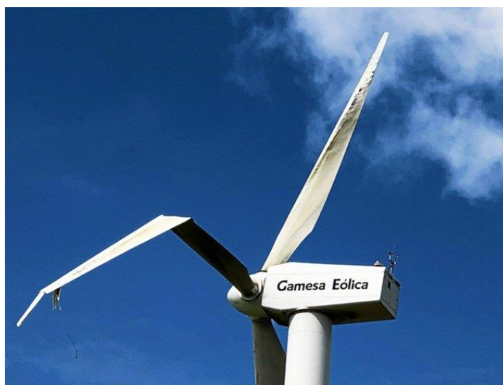
Figure 2.3 : Une pale sévèrement endommagée au parc éolien à Plouarzel
