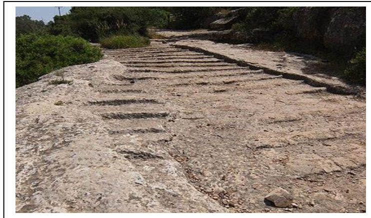
Figure. I.2 : Photo d'une route romaine dégradée
