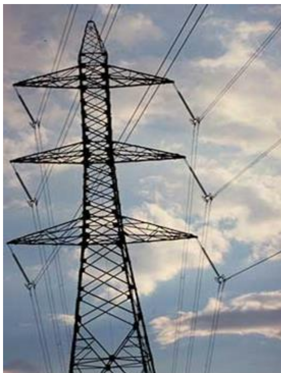
Figure I-5: Pylônes double drapeau (à deux circuits)
