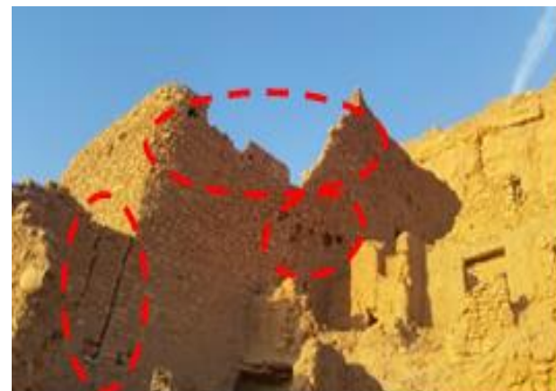
Fissuration profonde et effondrement de mur rempart
