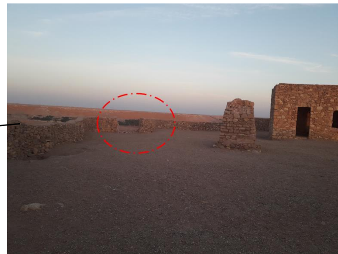
Effondrements des murs rempart
