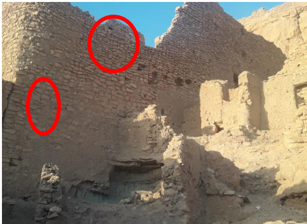
Figure 63: des fissures profondes source : auteures
