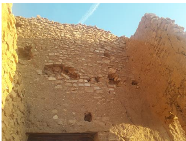
Fissuration superficielles et les trous
