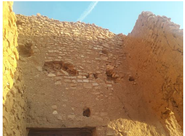
Figure 62: des fissures superficielles source : auteures
