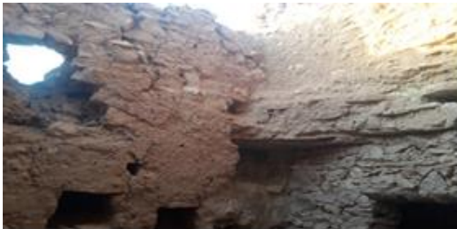
Figure 12: dégradation de crépissage de la maison rempart source: auteure
