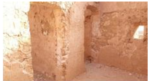
Figure 13: dégradation de crépissage de mur et revêtement de sol de la tour française source: auteur
