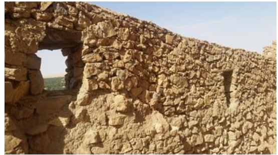
Figure 15: effondrement de la meurtrière source : auteure
