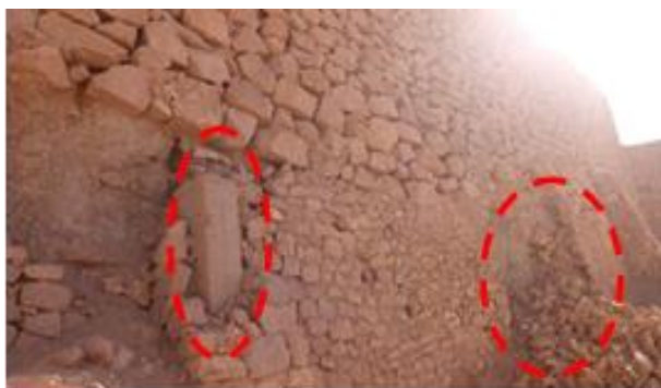
Effondrement des pierres au niveau de contrefort
