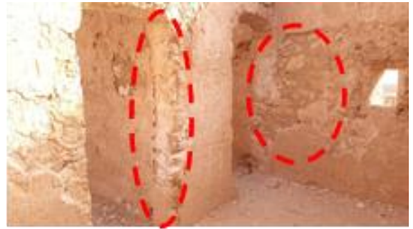
Figure 10: fissuration superficielle source : auteur
