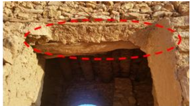
Figure 8: effondrement des linteaux source : auteure
