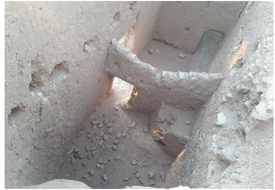
Figure 65: D'écoulement du crépissage source : auteures
