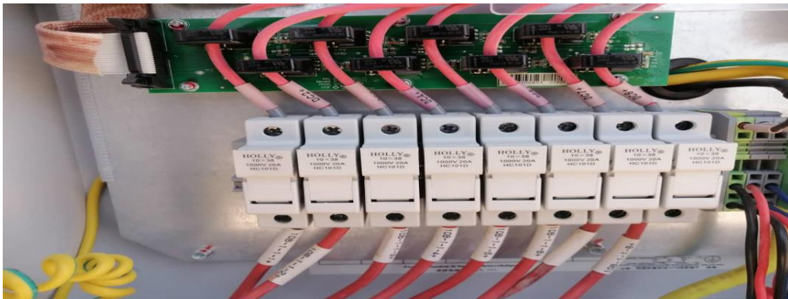
Figure III.9 : Fusibles avec les portes cote positive
