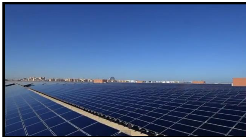
Fig. 51 : les panneaux photovoltaïques. Source : https://webdeveloppementdurable.com/dossier-masdar-loasis-verte-au-pays-de-lor-noir/3/
