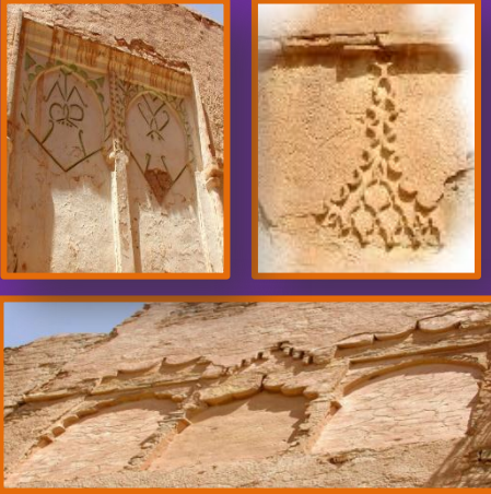
Figure 65: Couronnement et ornementation des façades et l'utilisation des arcs aveugles Source : photos prise par les étudiantes
