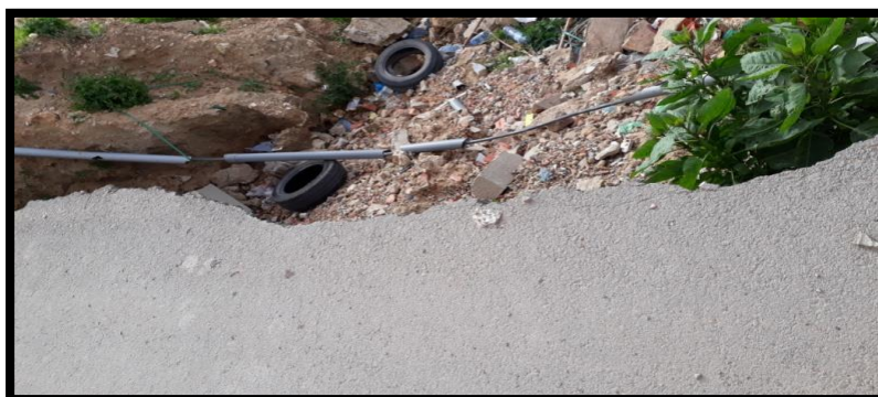
Figure 113 : l'état de la RN11 source : pris par l'auteur le 28/02/2018 à 17 :20
