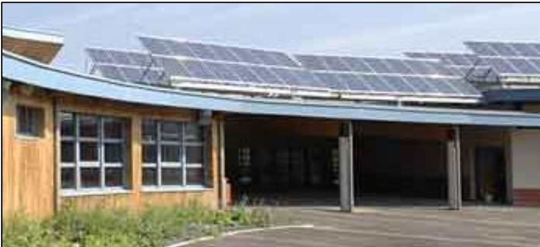
Figure 22 : Les panneaux solaires
