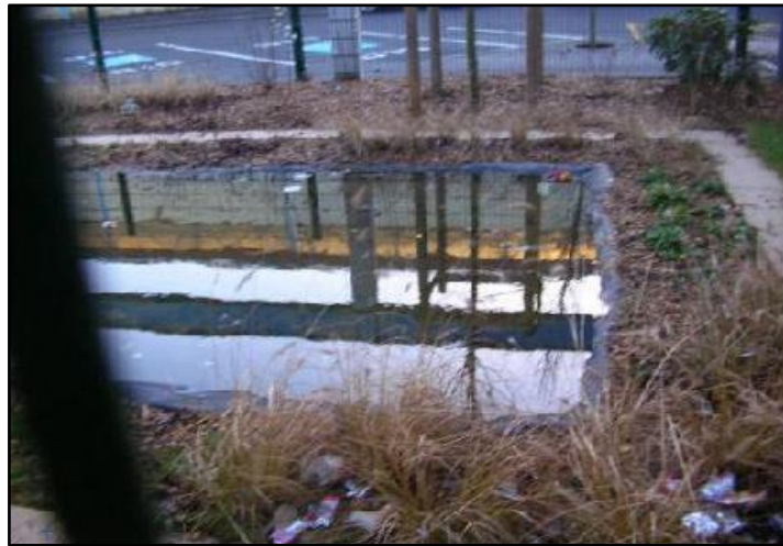
Figure 19 : Un bassin de rétention des eaux pluviales
