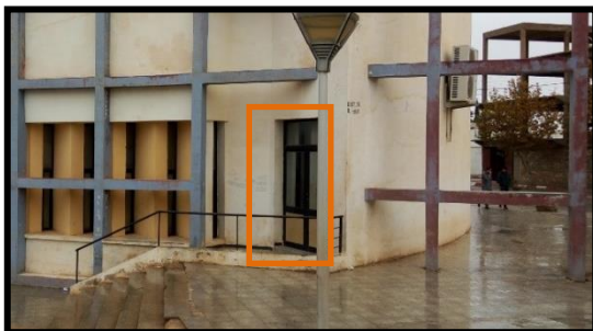
Fig69 : Issue de secours Source : auteur
