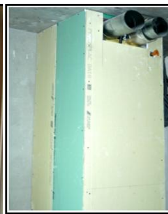
Figure 36 : Installation de ventilations double flux Source : Zac de Bonne, éco-quartier en centre-ville/pdf
