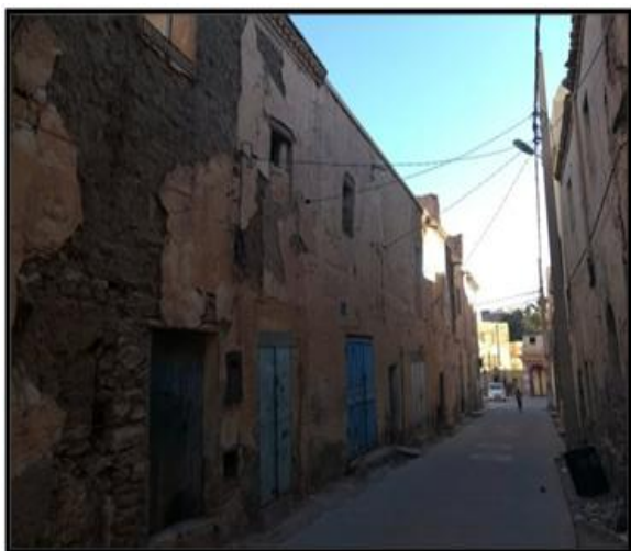
Figure 110 : Dégradation de la façade urbaine source : photo prise par l'auteur.
