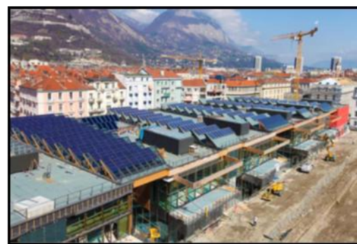
Figure 33 : Les panneaux photovoltaïques
