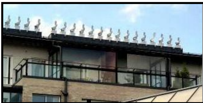
Figure 33 : l'échangeur d'air Source : www.helsinginenergia.fi/kaukolampo/ekoviikki.html
