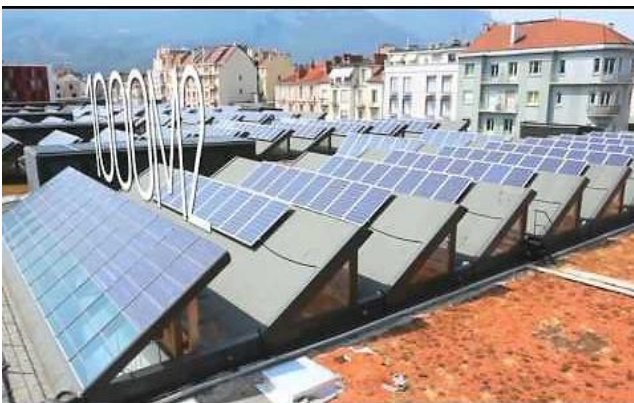
Figure 44 : les panneaux photovoltaïques Source : PDF de bonne de Grenoble
