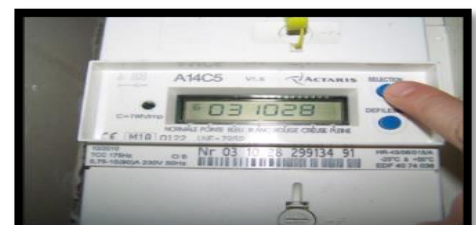
Figure 94 : Compteurs électriques source : https://lajoliemaison.fr/comparatif/le-meilleur-compteur-electrique/
