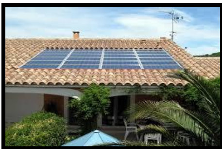
Figure IV-07: photovoltaïques en toiture Source : www.batirama.com
