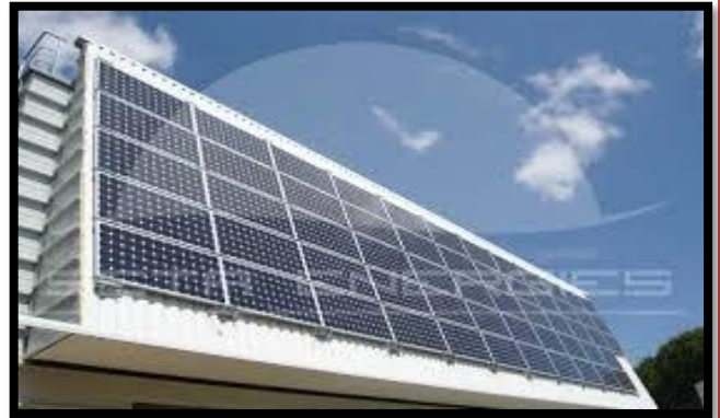
Figure IV-10 : photovoltaïques en façades Source : www.solaire-photovoltaïque-pro.fr
