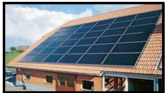
Figure IV-08 : photovoltaïques en toiture Source : www.batirama.com
