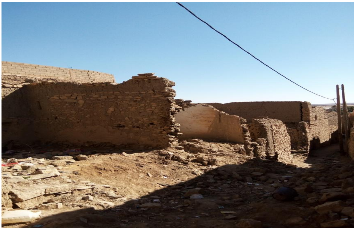
الصورة رقم (11): سقوط واجهات مساكن بقصر تاجموت
