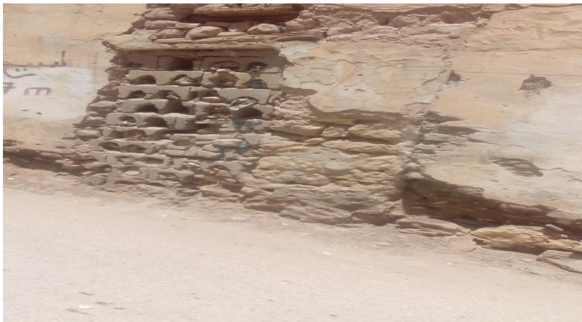
صورة رقم (03) : تآكل أساسات المباني
