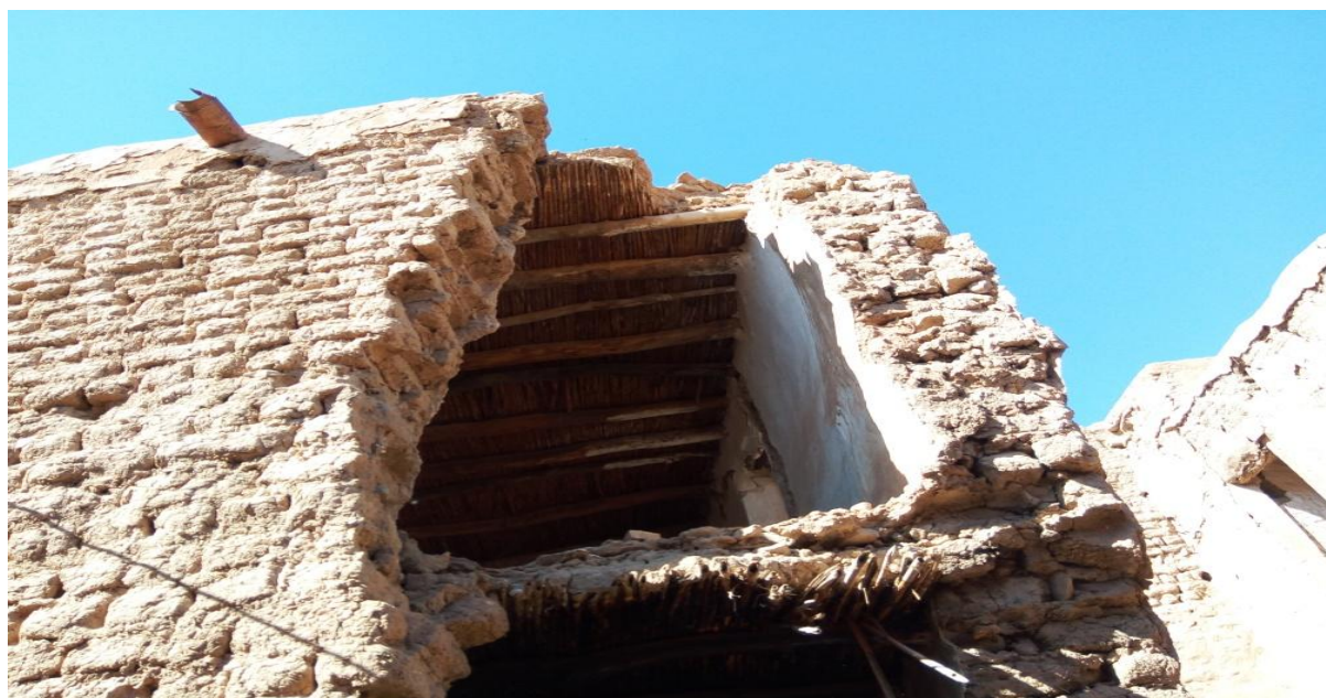
الصورة رقم (12) : تدهور واجهات مساكن بقصر تاجموت
