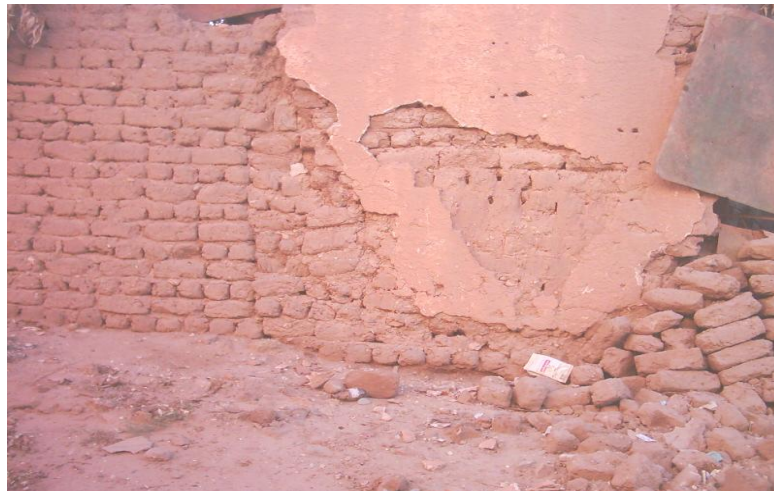
Figure 28 : Exemple typique de décrépitude d'un mur en adobe à Z'gueg el Hadjadj Source : Etudiants Département architecture 3 ème année (2005-2006)
