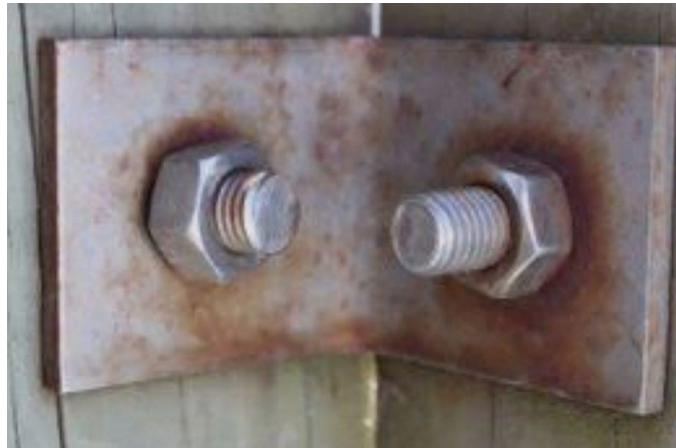
Figure-5 : photo représente la corrosion galvanique.
