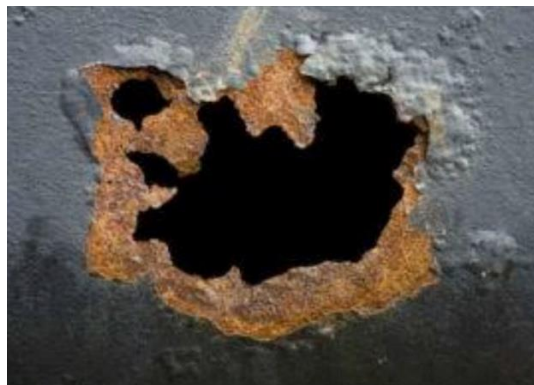
Figure-4 : photo représente la corrosion localisée.
