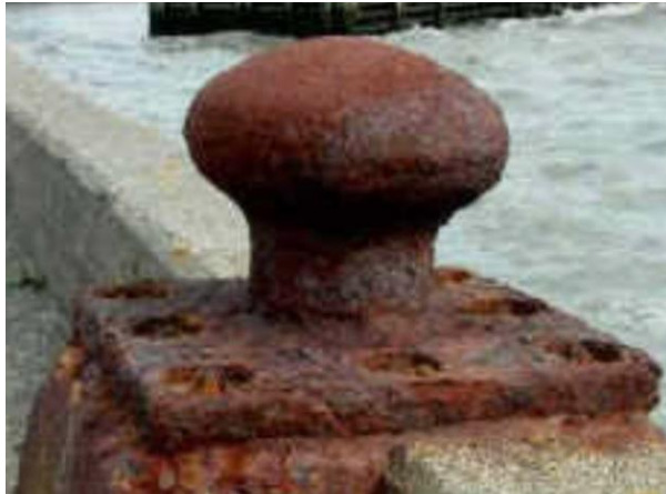
Figure-3 : photo représente la corrosion uniforme.
