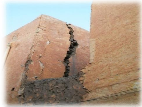
Figure 11 : dégradation du bâti Source : les étudiants
