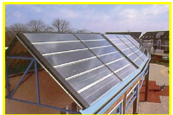
Figure .II. 3 : les capteurs solaires de la crèche de reine (arch. B. Pierre) [Source : "Traité d'architecture et d'urbanisme]
