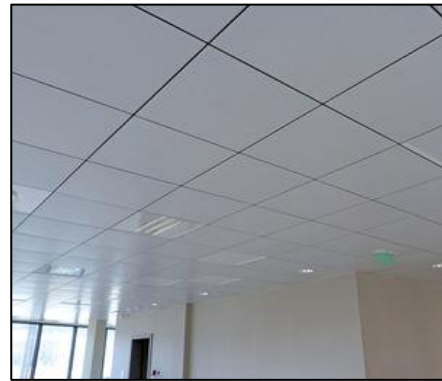
Fig. 11 : Faux plafonds. [Source : http://www.archiexpo.fr ]
