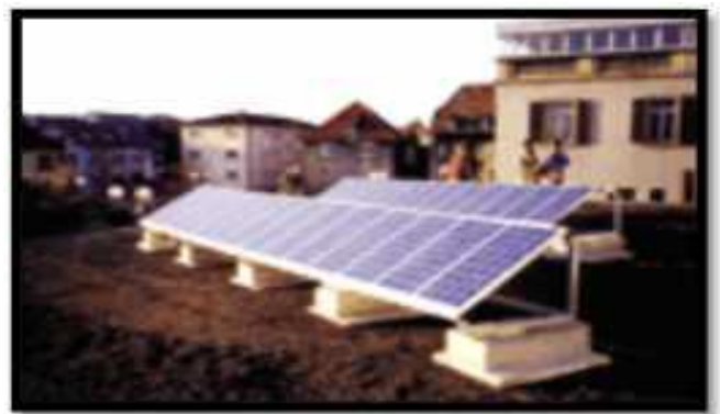
Figure 12 : les panneaux solaires.
