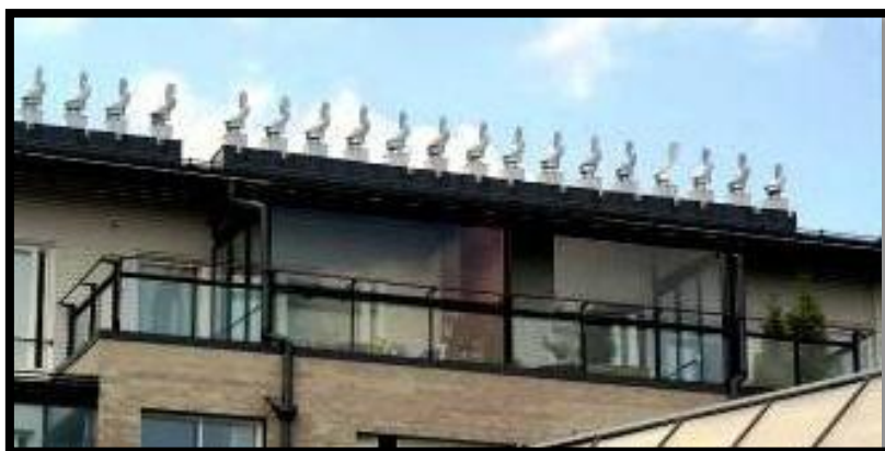
Figure 33 : l'échangeur d'air Source : www.helsinginenergia.fi/kaukolampo/ekoviikki.html
