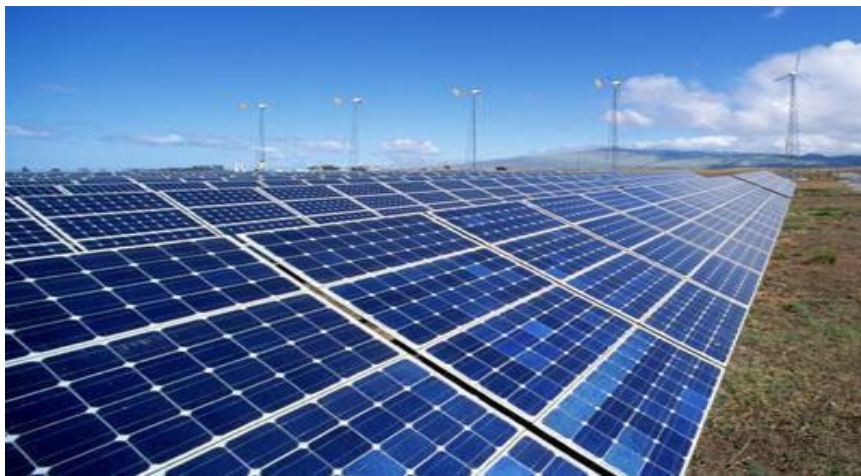
Figure I.6. Les panneaux photovoltaïques fixes
