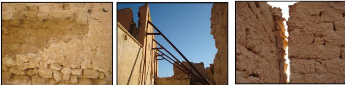
Figure I 5. Les désordres du mur en brique de terre (toub) [9].
