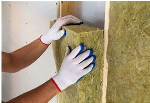
Figure 1-6. Isolation avec laine de roche [29].
