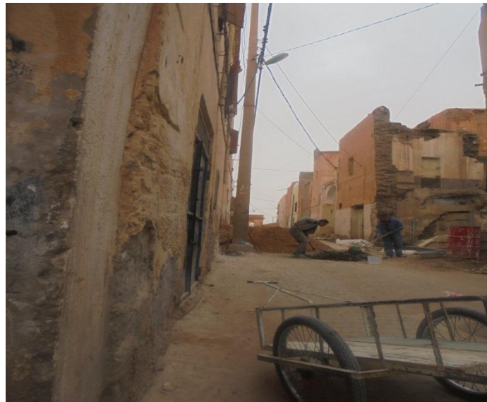
Figure 26, II : mal organisation des chantiers, prise par l'étudiantes
