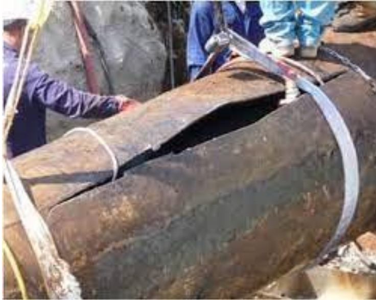
Fig.I.2 : Eclatements avec rupture franche de la canalisation[21].
