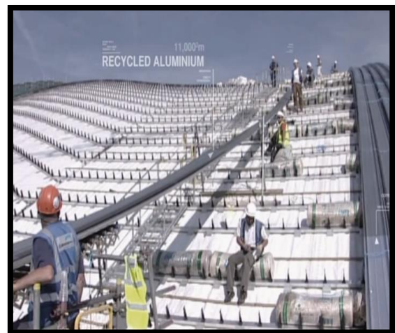
Figure n 29: matériaux recyclés au stade Source : www .ide.gov.uk
