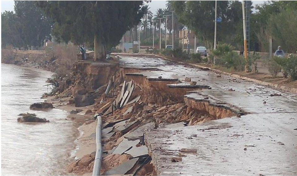
Figure II.5: Description de l'effondrement de la route de Khat El Oued 2016 [10] .
