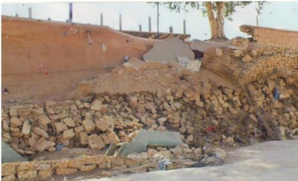
Figure II.6: L'effondrement du Mur en Gabionnage au niveau de Khat El Oued [10].
