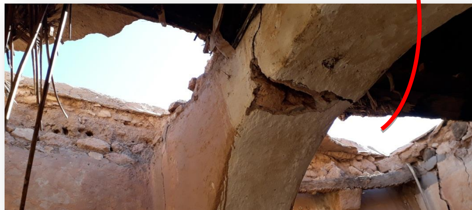
Figure 24 : L'effondrement du plancher (cuisine) - source : Auteur
