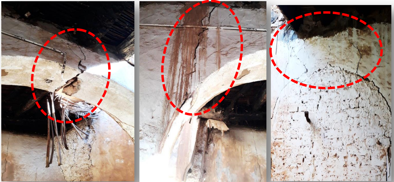
Figure 15 : Fissure profonde dans la clé d'arc effort de compression – source : Auteur
