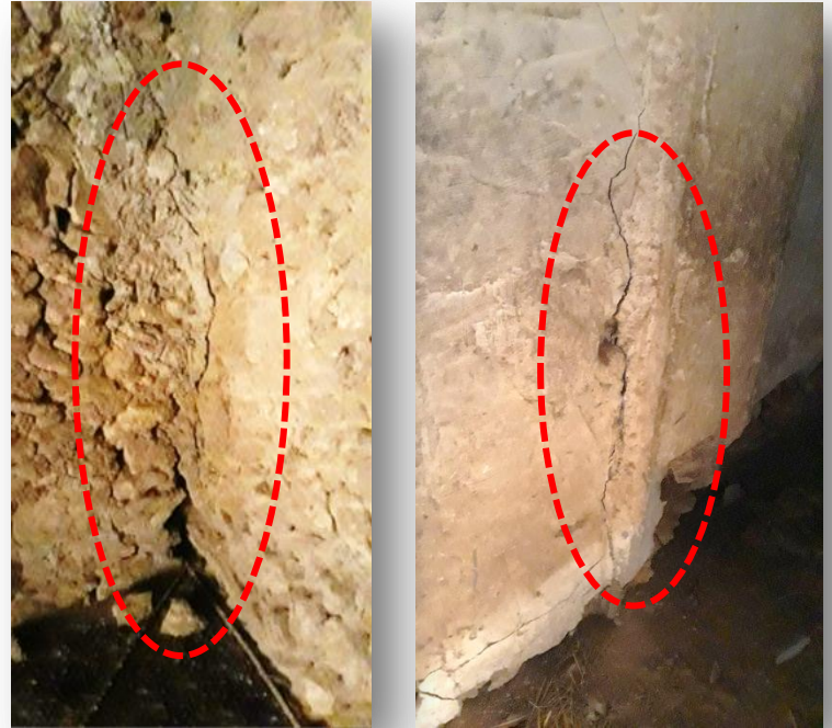
Figure 6 : Fissures montantes dues aux sollicitations des fondations, a : le mur Tahja, b : mur de la chambre – source : Auteur
