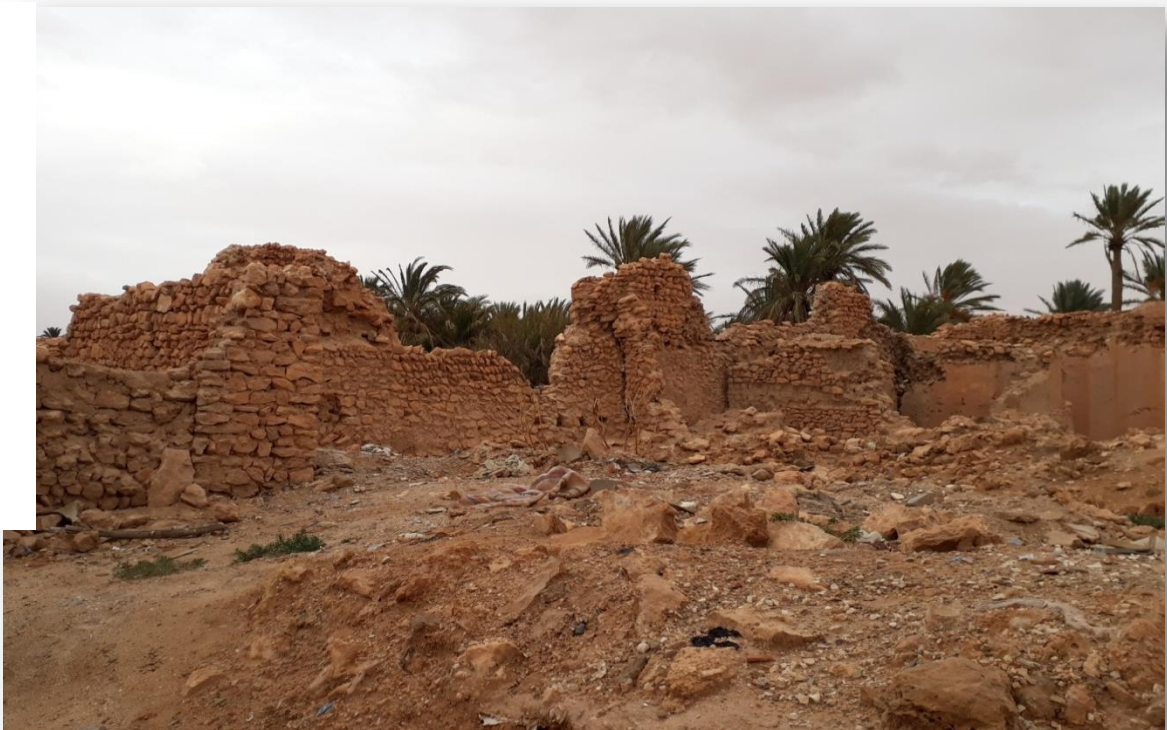
Figure 52 : L'effondrement de la partie nord du ksar - Source : Auteur
