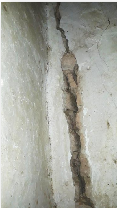
Figure 16 : Lézarde– source : Auteur
