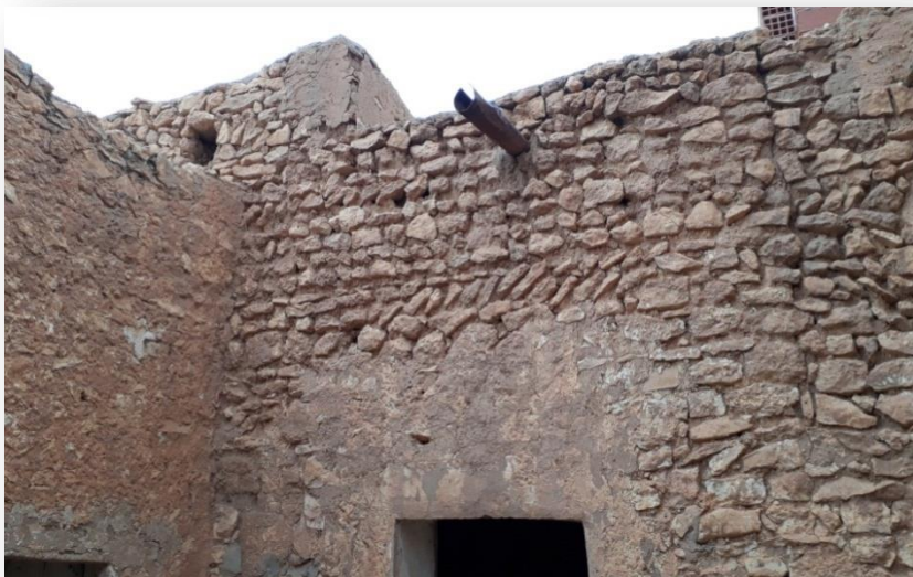
Figure 13 : Décollement des revêtements, a ; revêtement de la façade latérale, b : revêtement de la façade principale, c : revêtement de l'un des murs de patio, d revêtement de l'un des murs de Tahja - source : Auteur
