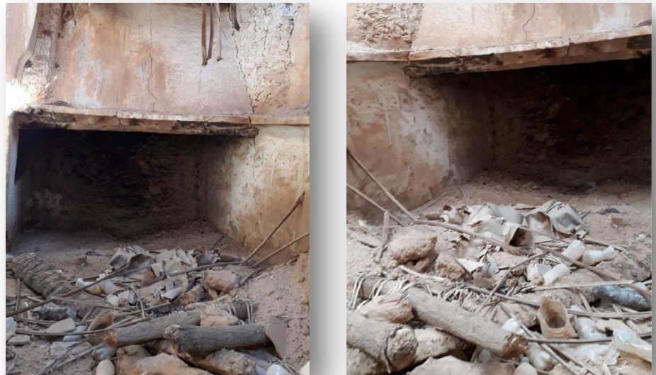
Figure 25 : Désordre dû à l'effondrement du plancher - source : Auteur
