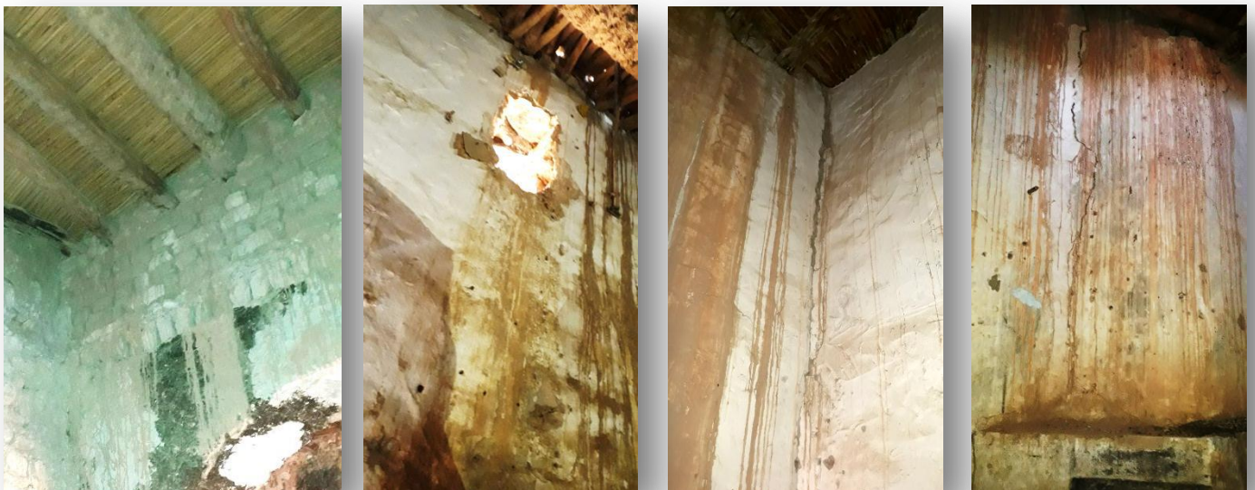
Figure 26 : L'infiltration des eaux pluviales, a : plancher Tahja, b : plancher chambre, c : plancher chambre, d : plancher chambre au-dessus de cheminé - source : Auteur
