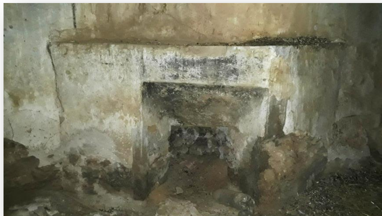
Figure 20 : Cheminée de la chambre- source : Auteur
