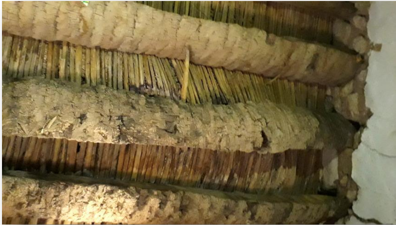
Figure 22 : Fléchissement des solives (entrée) - source : Auteur
