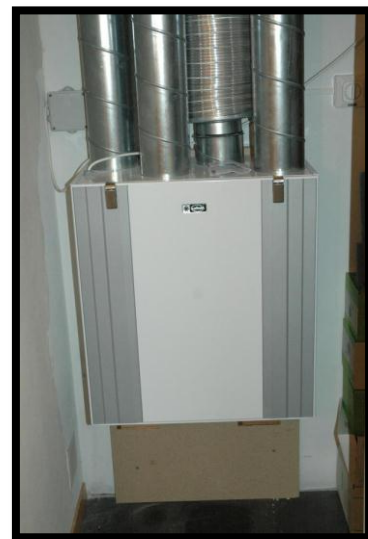
Figure I-50: photo représente VMC source : http://lab-immo.ch/1037/-/ Minergie-P-ECO MAISON
