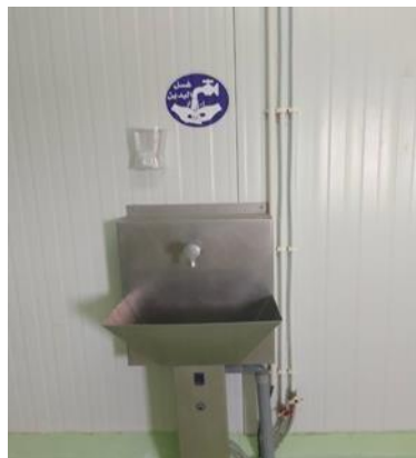
Photo 05 : Installations de lavage des mains (photo originale).
