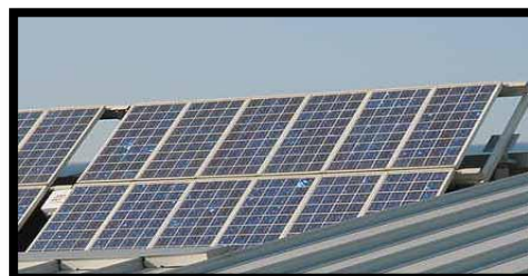
Photo 26 : Les panneaux photovoltaïques
