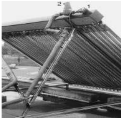
Figure II.18 Exemple de capteur solaire sous vide (avec sonde de température en 1 et purgeur en 2).
