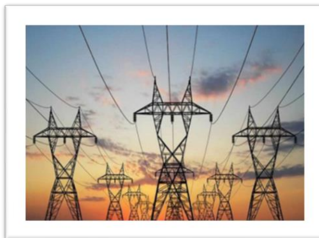
Figure (1.5) - ligne de transmission avec tours en treillis autoportantes. .
