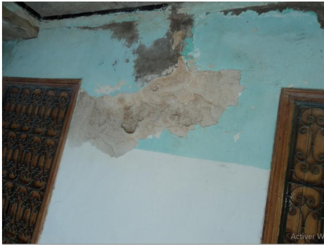
الصورة 22 : توضح تاثير الرطوبة على جدار المسجد جهة الفناء الشمالي
