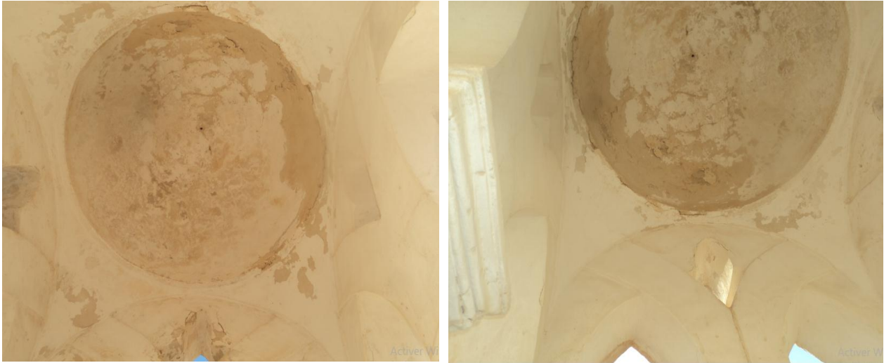
الصورة 32 : توضح تأثير الرطوبة وتشققات المنارات على مستوى القباب من الداخل
