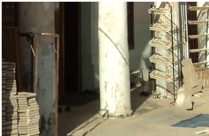
الصورة 09 : توضح تأثير الرطوبة على الاعمدة و الجدران و الطلاء للمسجد
