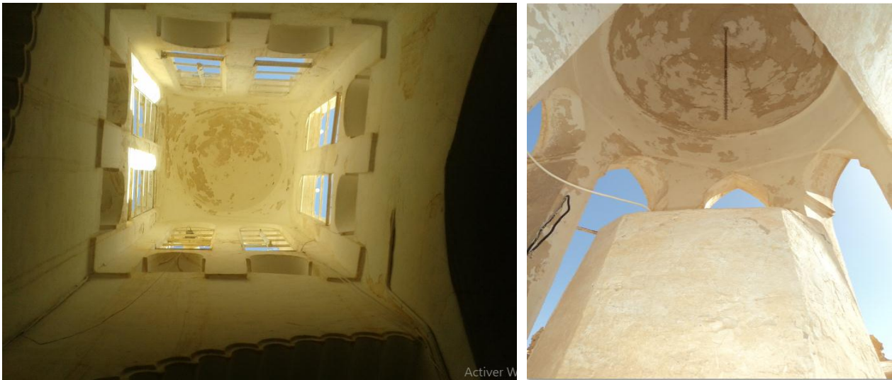
الصورة 32 : توضح تأثير الرطوبة وتشققات المنارات على مستوى القباب من الداخل
