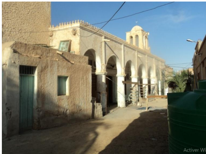
الصورة 08 : توضح تدهور حالة الواجهة الشمالية للمسجد
