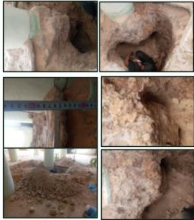
الصورة 43 : توضح قياس عمق الحفر للكشف عن الرطوبة
