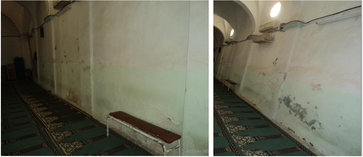
الصورة 34 : توضح تأثير الرطوبة على مستوى الجدران الداخلية لقاعة الصلاة
