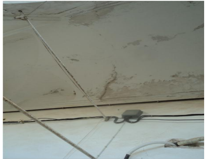
الصورة 23 : توضح تاثير الرطوبة على مستوى سقف المسجد جهة الفناء الشمالي
