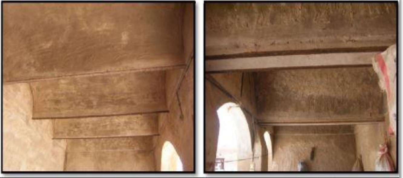
الصورة 9. طريقة استعمال الفولاذ في بناء الاسقف بالحي العتيق الاعشاش المصاعبة بالوادي
