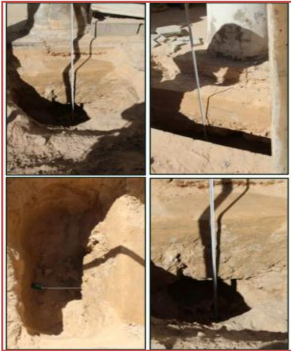
الصورة 39 : توضح الحفر للكشف عن الرطوبة
