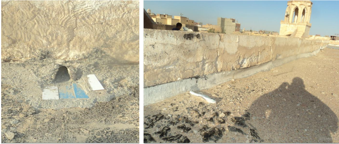
الصورة 28 : توضح التشققات على مستوى جدار الحماية بسقف المسجد
