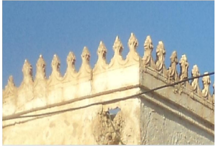
الصورة 12 : توضح تسرب المياه من السقف و تأثيرها على عناصر الواجهة
