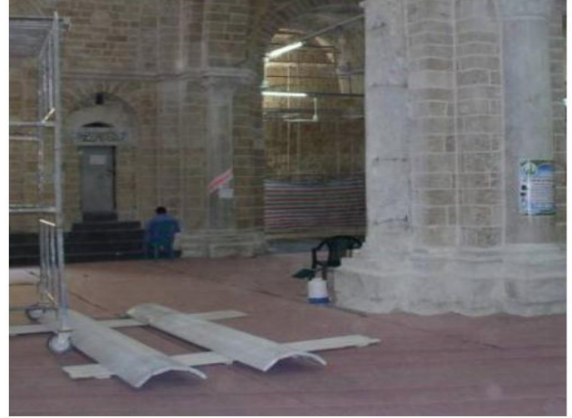
(أ): حالة عمود الرخام قبل عملية الترميم
