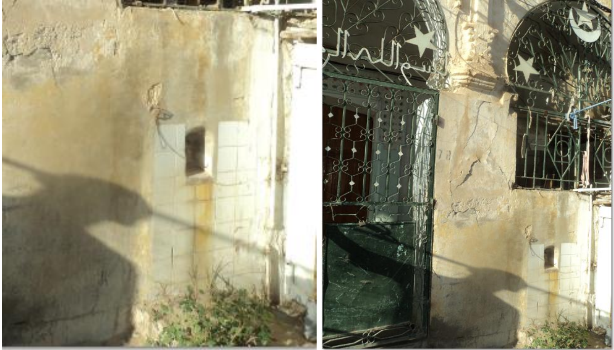
الصورة 10 : توضح تاثير الرطوبة الجدار الخارجي (السور) للمسجد
