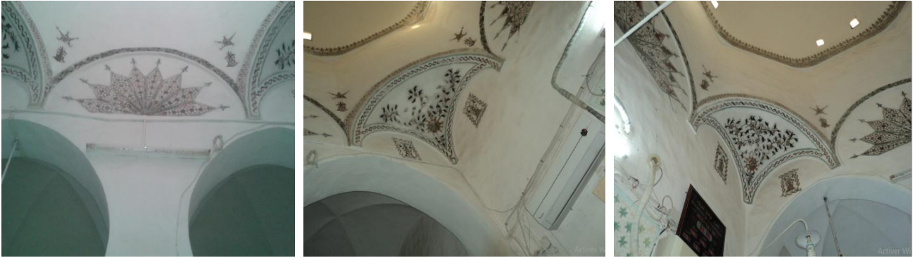
الصورة 38 : توضح الشقوق و تلف الزخرفة من القبة داخليا
