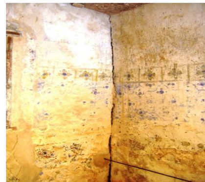
صورة 52: مناظر تشققات المبنى.
