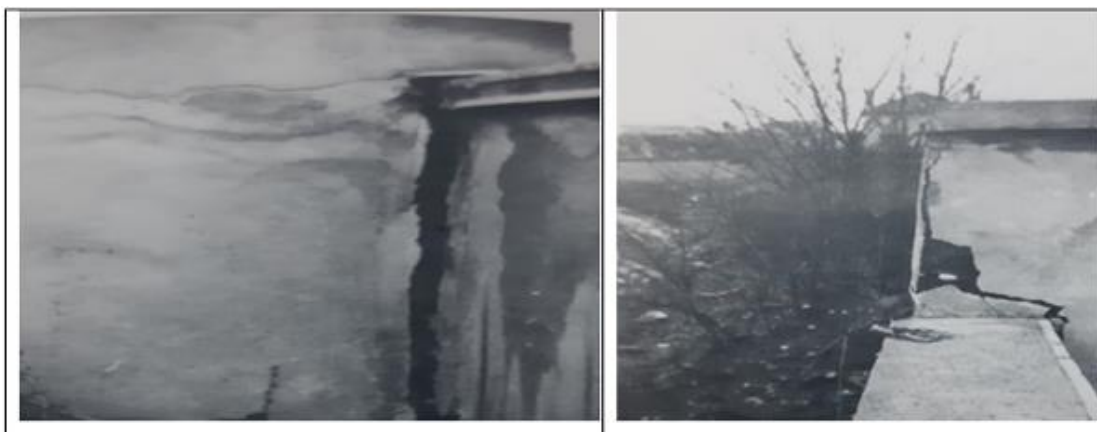
Figure II.12 : Fissures à la jonction du garage et du mur de clôture [16].
