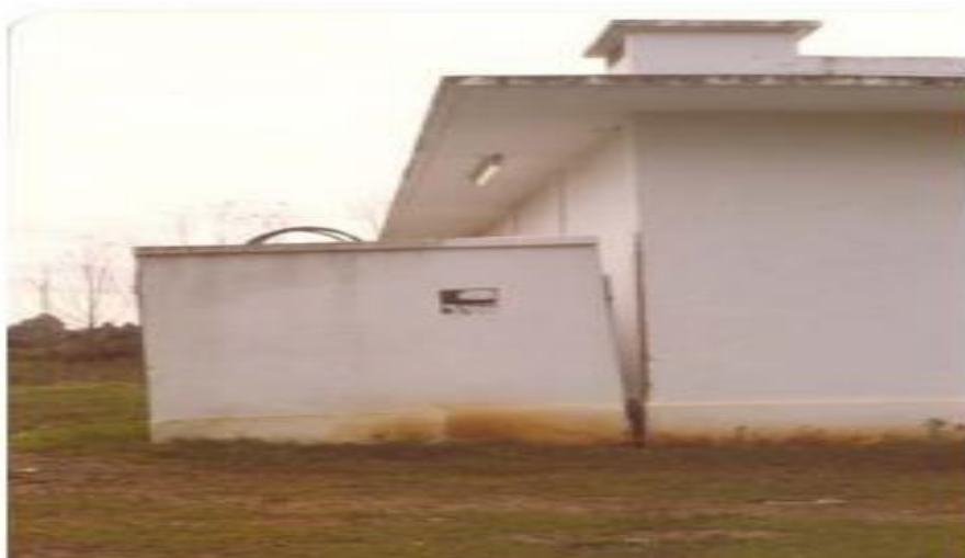
Figure II.24 Tassement différentiel du terrain sous les fondations d'une station de pompage (SP13, Garb) [20].
