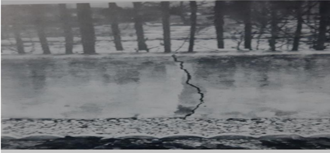
Figure II.13 : Fissures dans le mur de clôture [16].
