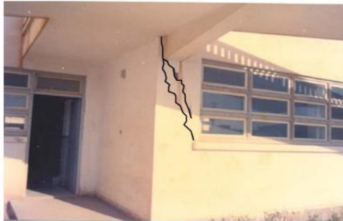
Figure II.22 : Dégradations dues au gonflement du sol [20].
