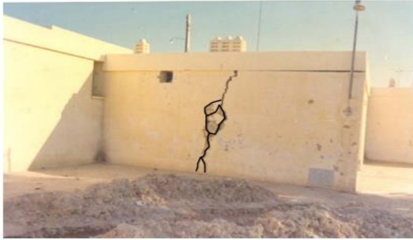
Figure II.23 : Tassement différentiel du terrain au-dessous de la fondation d'un mur (Oued Zem) [20].
