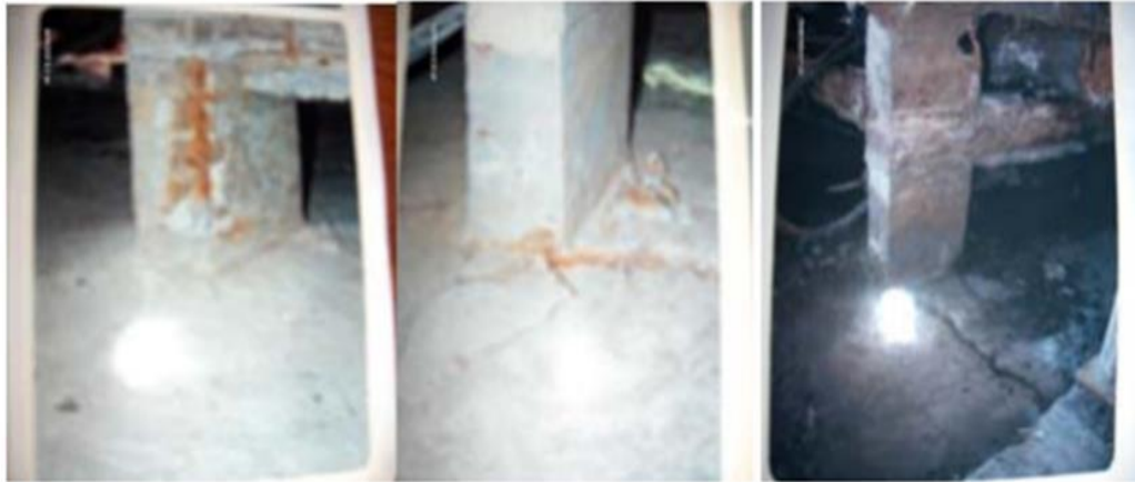
Figure III.11: Colonnes primaires rouillées et fissures importantes dans la fondation
