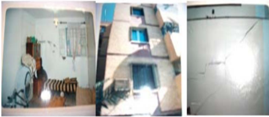
Figure III.9 : Fissures dans les murs extérieurs et intérieurs
