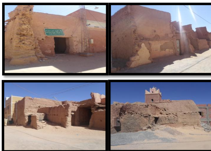
Photo.II.3 : Les dommages causés par les travaux de la voie
