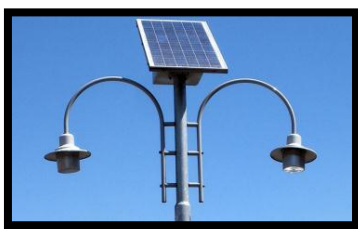
Photo. II.4 : Éclairage public autoalimenté par énergie solaire La source : gabonreview.com
