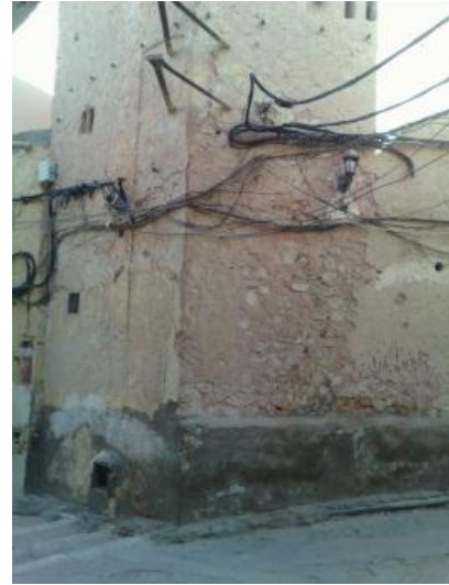
Figure 99 : Fils d'électricité apparent qui défigurés les façades. Pris par les étudiants
