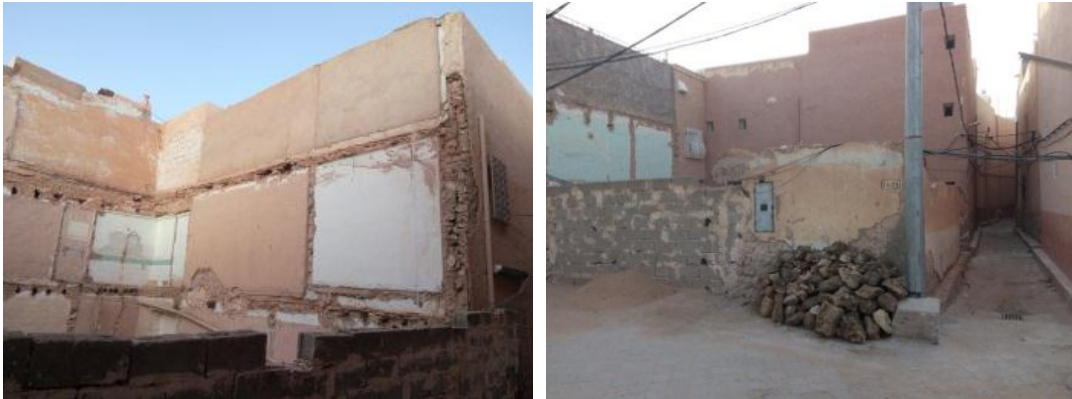
Figure 83: maison effondré. Pris par les étudiant.
