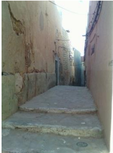
Figure 90: fissure inclinée. Pris par les étudiants
