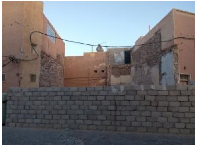
Figure 154 : la maison effondrée. Pris par les étudiants
