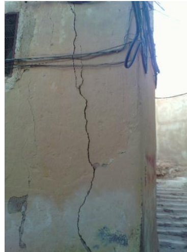
Figure 91: fissure verticale. Pris par les étudiants
