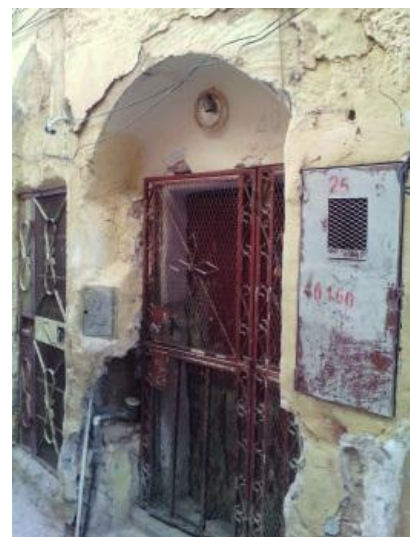
Figure 98: fuite au niveau du compteur. Pris par les étudiants
