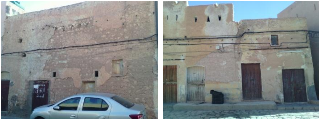
Figure 86: enduit détérioré. Pris par les étudiants
