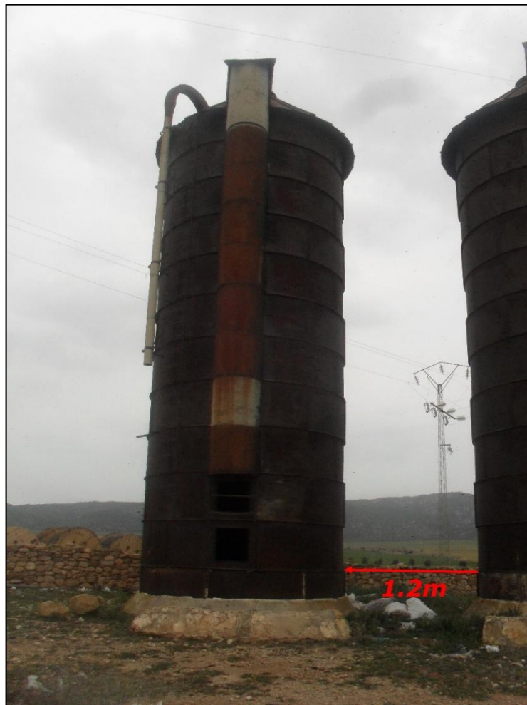
Figure 44 : le silo de stockage
