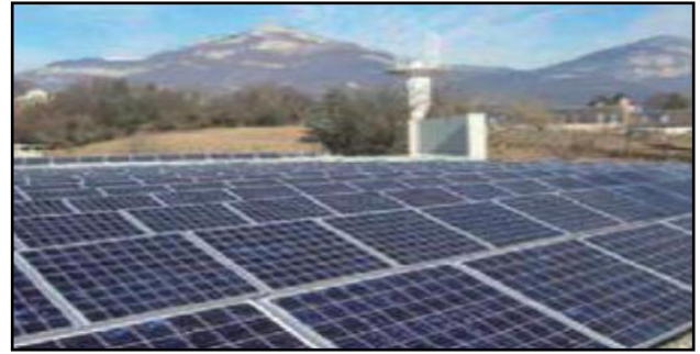
Fig.I-13 Panneaux photovoltaïques [Source : novation écologique, Transformer sa maison au naturel: isoler, restaurer, décorer].
