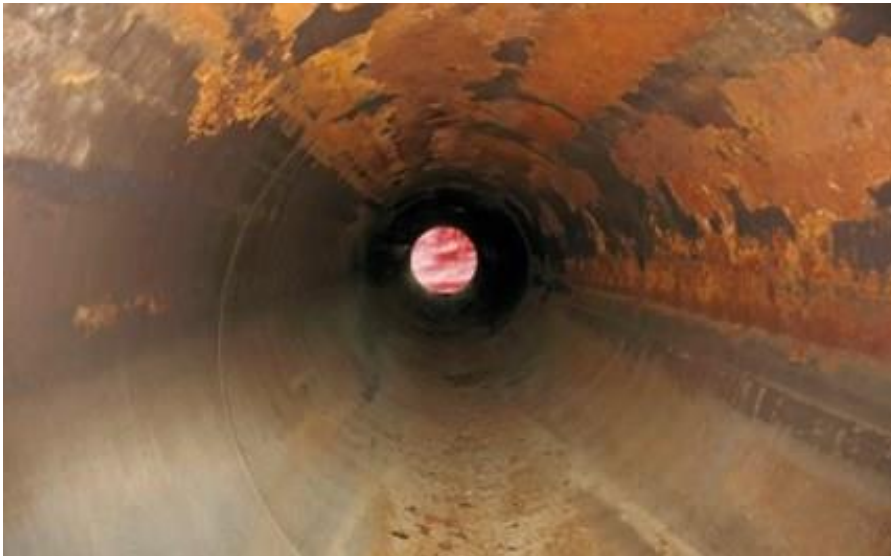
Figure1 : Corrosion un problème industriel majeur
