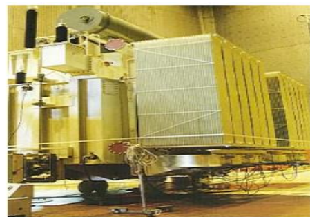
Figure (I.8) Radiateurs sur un transformateur
