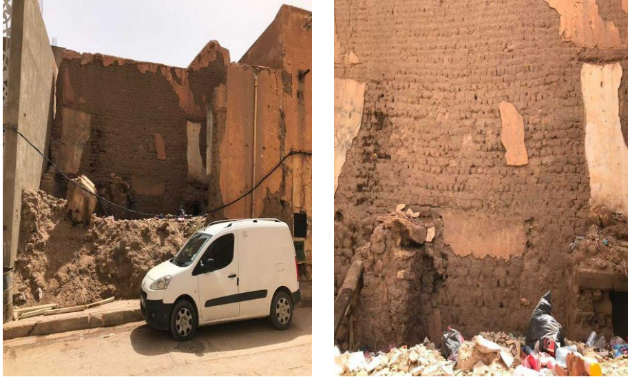
Figure 19. Les désordres du mur en brique de terre (Toub) à Ksar Lebzayem
