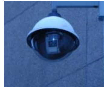
Figure 148 : Caméras de surveillances extérieures
