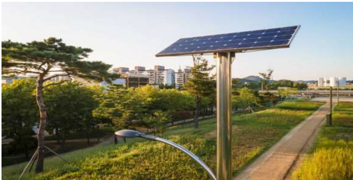
Figure 137 : l'éclairage photovoltaïque autonomes.
